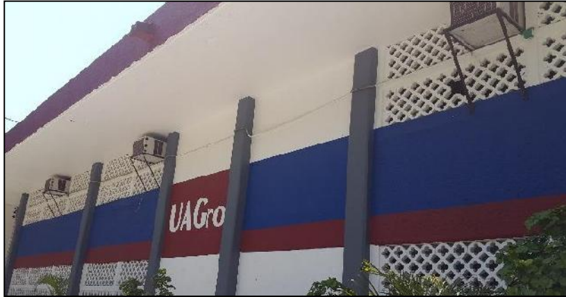
Fig. 6.17. Aires Acondicionados obsoletos
