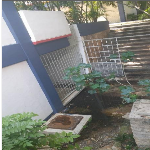
Fig. 6.25. Escurrimiento de agua en la UCDR
