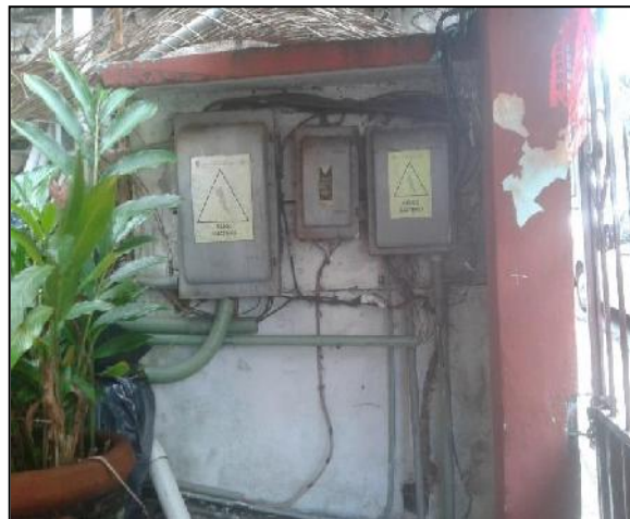
Fig. 6.29. Malas condiciones de la instalación eléctrica
